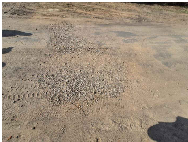
Fot. 11. Zdegradowana, wymagająca remontu droga powiatowa w Dobropolu Gryfińskim
