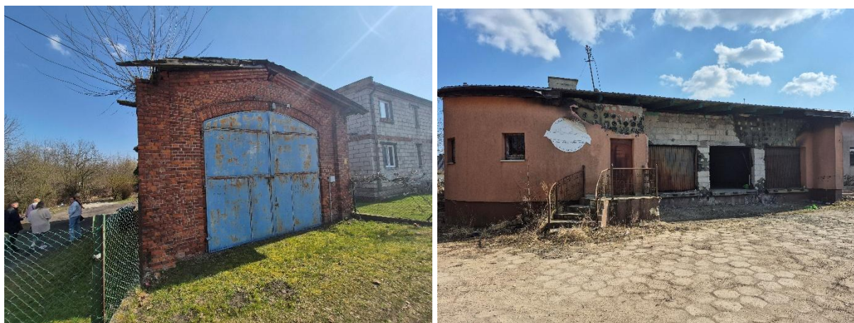
Fot. 5. Zdegradowane obiekty w Starym Czarnowie
